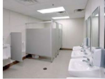
SANITARIOS Y REGADERAS
